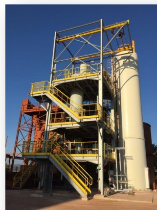
Station de traitement de l'eau
